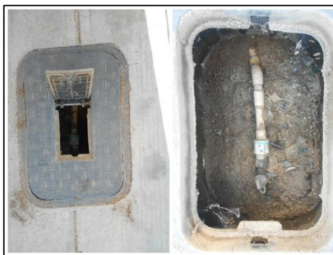
Fig. 3.9 Falta de regularización de servicio de agua
