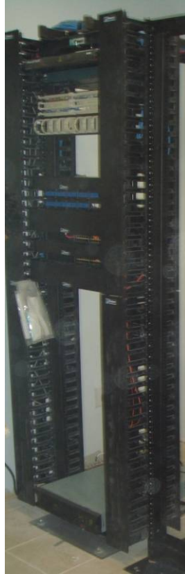
Figura 20. Foto de Rack instalado para dar servicio de red al almacén y gabinete
