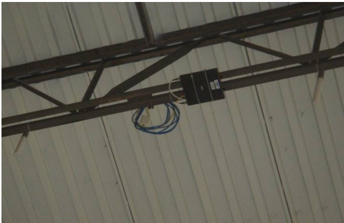
Figura 19. Ilustra 1 de los 10 AP instalados con sus respectivas antenas
