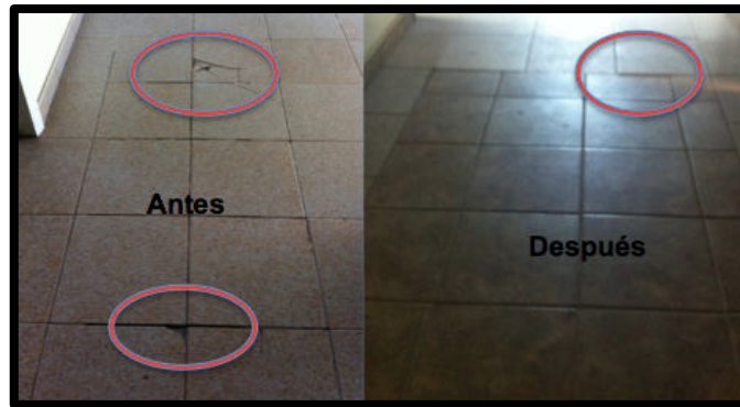
Figura 82. Loseta del tercer piso del edificio de dirección
