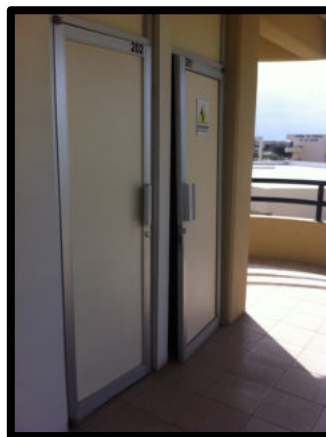
Figura 99. Centro de cargas del edificio de dirección
