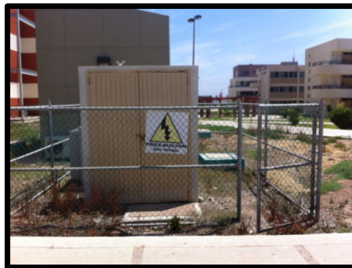
Figura 96. Subestación eléctrica ubicada atrás del DIA
