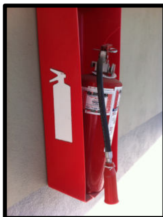
Figura 91. Extintor del edificio D
