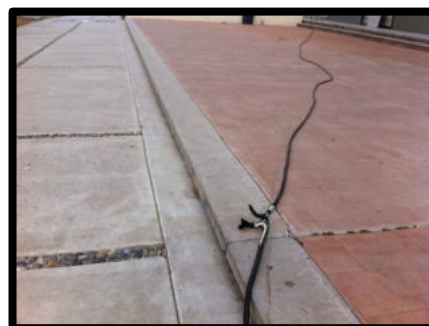
Figura 97. Cable en la explanada del edificio D
