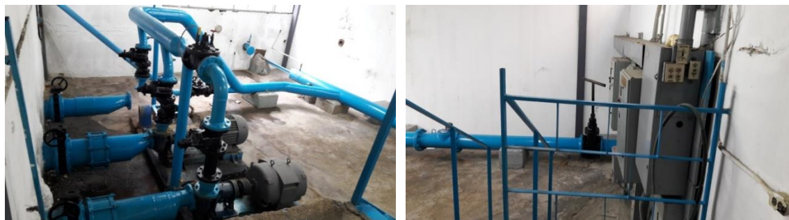
Figura 32. a) Equipo de bombeo; b) Tablero eléctrico
