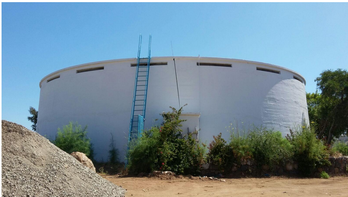
Figura 31. Tanque de almacenamiento Keki
