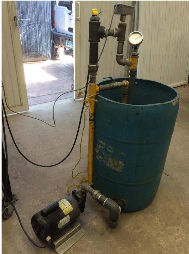
Figura 43. Recipiente con calefactores de temperatura y bomba para alimentación de agua
