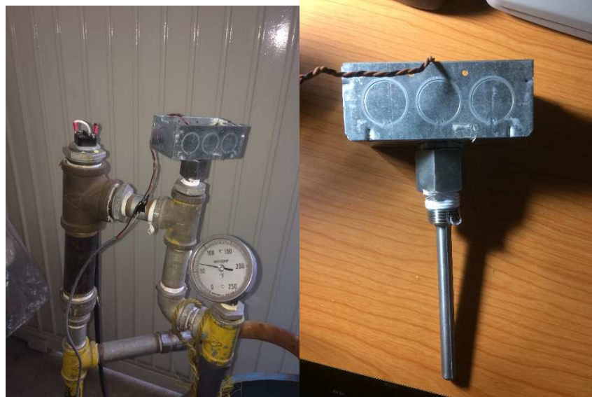
Figura 40. Montaje del sensor de temperatura PT-100
