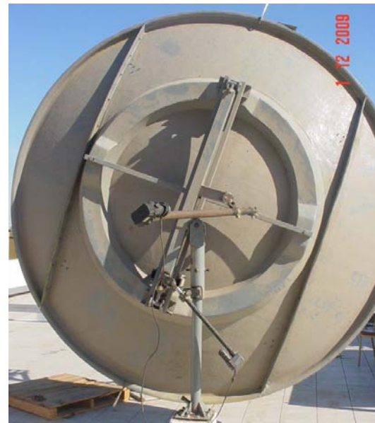
Figura 4.2. Montaje del concentrador solar y actuadores lineales para el sistema de seguimiento en dos ejes.
