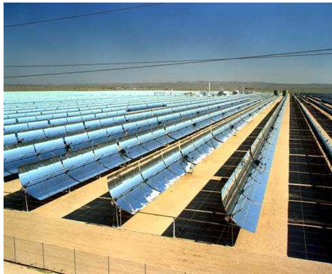
Figura 2.3. Planta de generación eléctrica solar de 354 MW.
