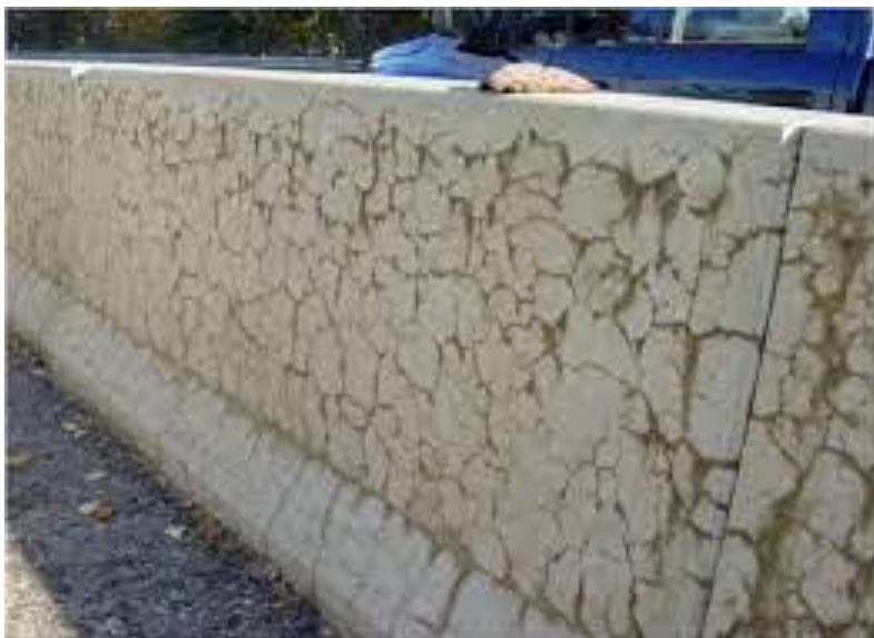
Ilustración 5. Falla por expansión interna en elemento de concreto hidráulico. Fuente: Instituto Mexicano del Transporte.
