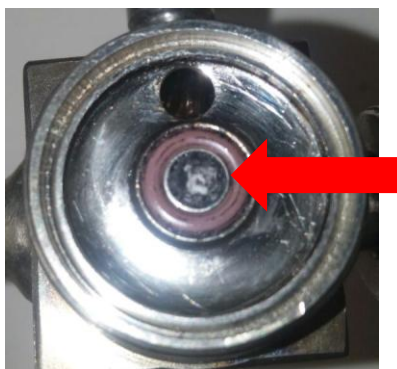
Figura 20. Válvula ALD 3 vías obstruida con un tapón de Al 2 O 3 debido a una fuga en el sistema ALD.
