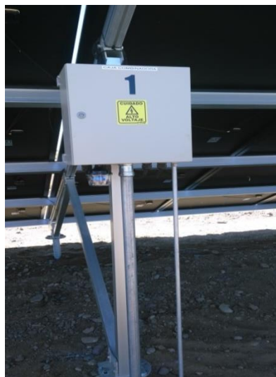
Figura 39.- Caja Combinadora del sistema, dentro barra o bus de paralelismo de tierras físicas.
