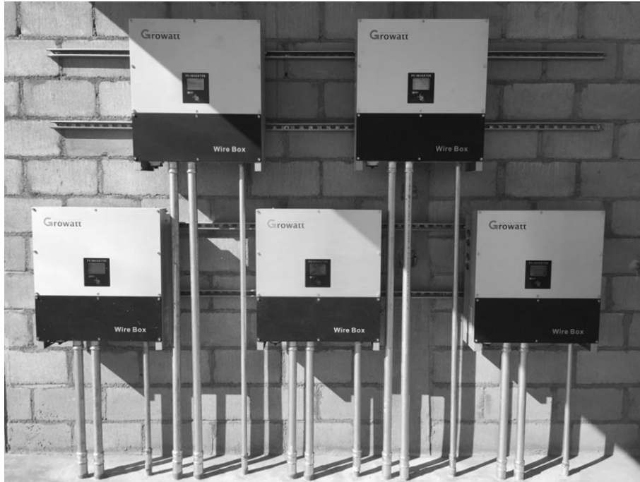
Figura 38.- Fotografía Tomada instalaciones USPR AGROINDUSTRIAS DE CABORCA.
