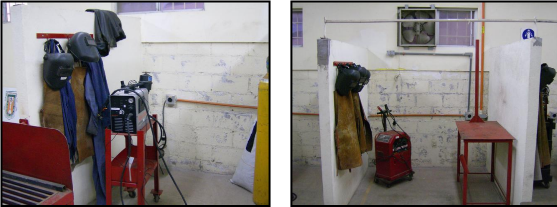
Figura 16 Dispositivos de seguridad para trabajos de soldadura en laboratorio de máquinas y herramientas
