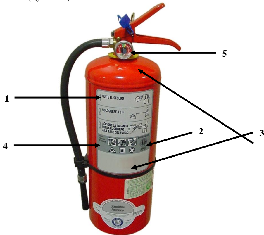
Figura 5 Puntos de Verificación del Extintor
