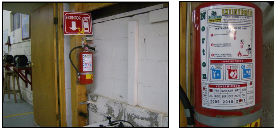
Figura 18 Sistema contra incendio del laboratorio de máquinas y herramientas
