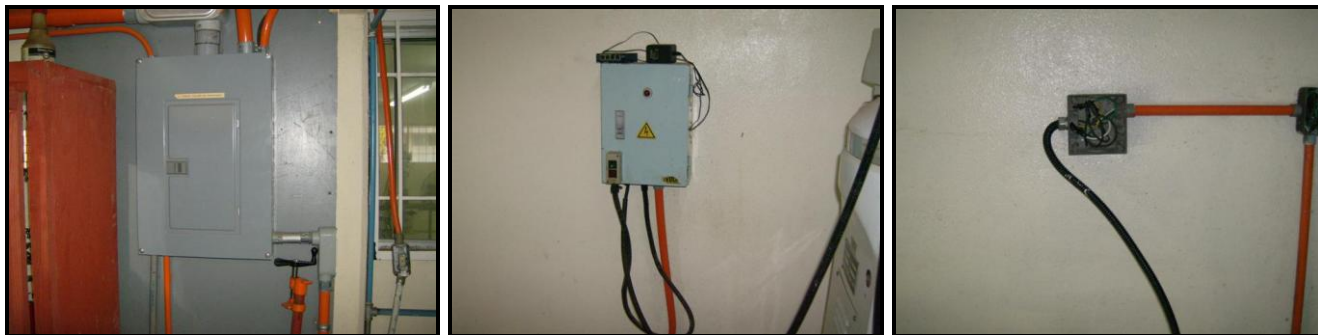
Figura 20 Instalaciones eléctricas del laboratorio de maquinas y herramientas
