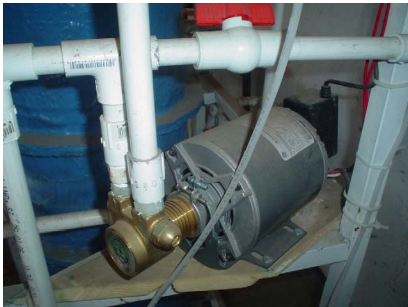
Figura 41. Bomba centrífuga de corriente alterna para pruebas
