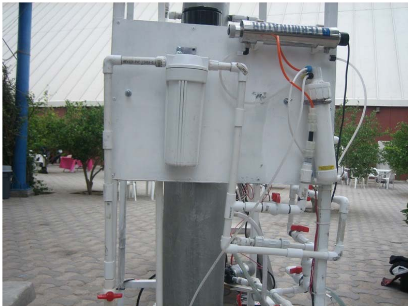
Figura 44. Vista de las conexiones de flujo de agua
