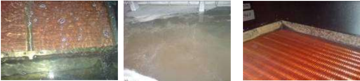
25. Intercambiador de calor, sumergido en una tina de enjuague, sin la aplicación de inhibidores de corrosión.
