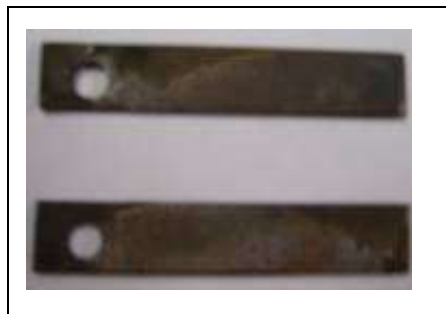
19. Placa de acero después de 7 días exposición. Su apariencia indica un proceso de oxidación bastante dañino.
