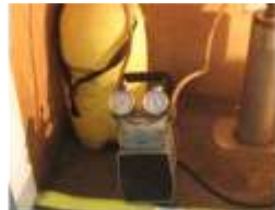
2.- Conexión de bomba de vacío
