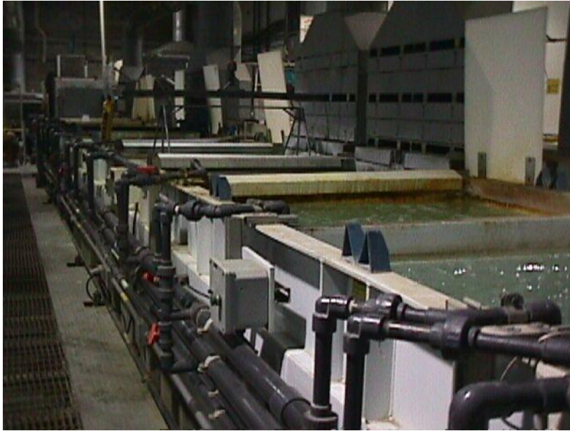
Figura 2.3. Detalle de las instalaciones de una línea de cromatizado donde se pueden apreciar tuberías, baños y sistemas de control y extracción de emisiones.
