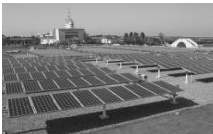
Figura 2.9 Campo de energía eléctrica fotovoltaica en Shanghai. China (Partain. et al. 2010).
