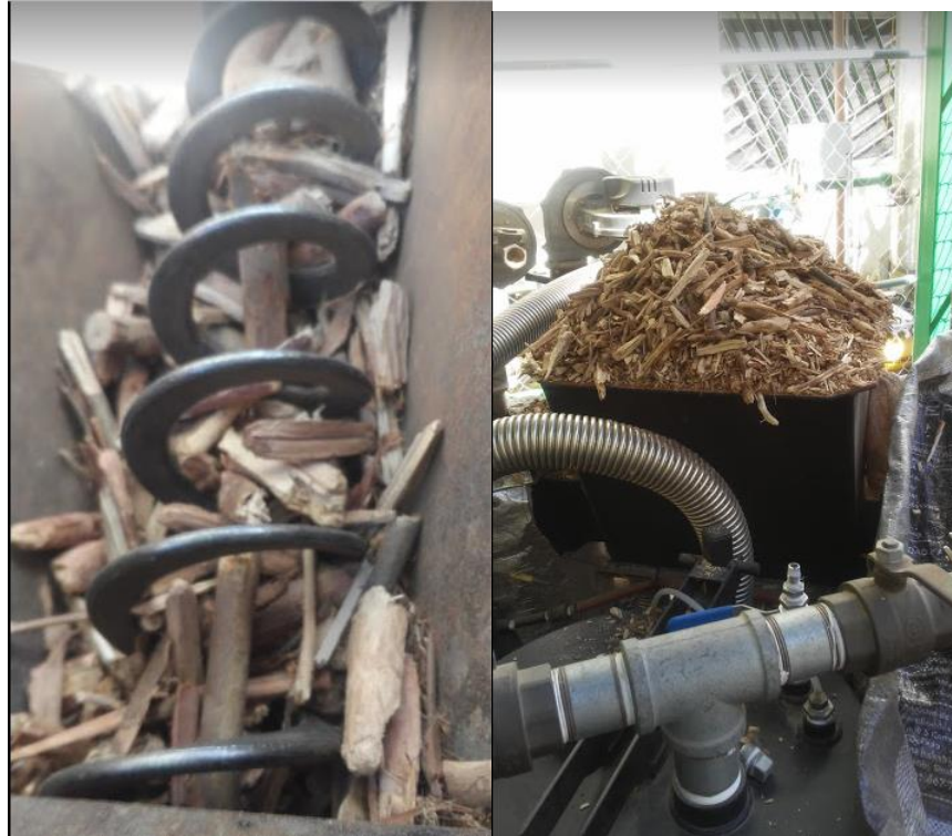
Figura 47 Tornillo de alimentación sin poder girar (izquierda). Biomasa sin la tolva colocada (derecha).
