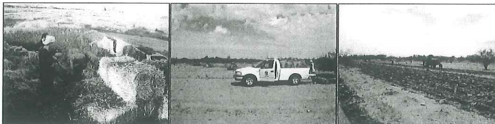
Figura 3.1 Trabajos de mejoramiento del suelo en el campo de la Escuela de Agricultura de la Universidad de Sonora.
