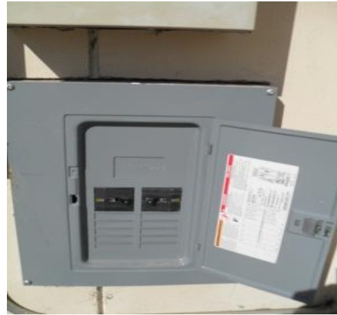
Foto 34. Centro de carga
