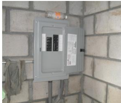
Foto 36. Centro de carga
