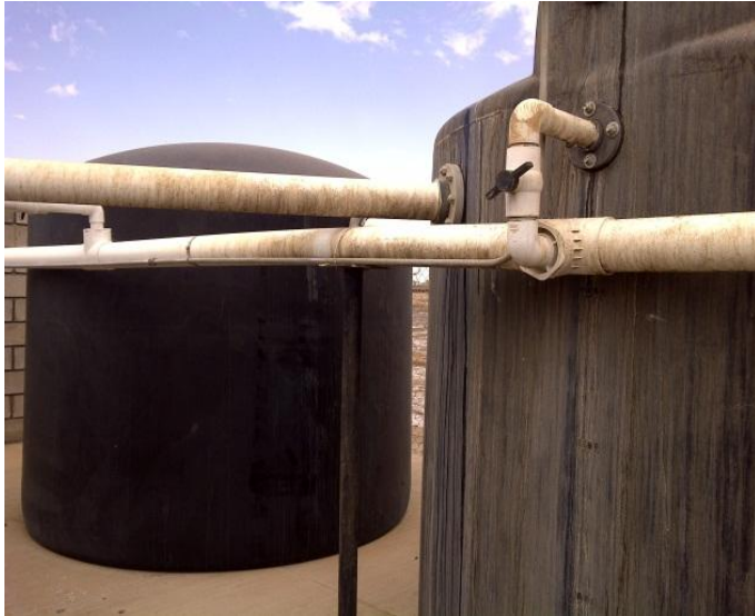
Foto 41. Fugas de la PTAR
