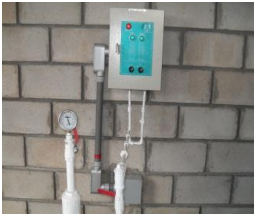
Foto 35. PLC de motobombas
