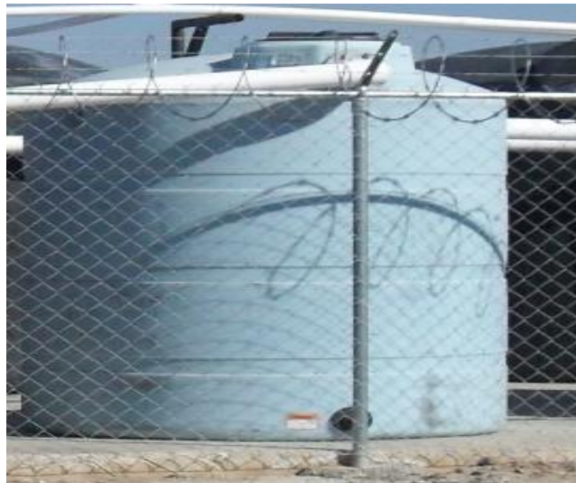
Foto 4. Tanque de contacto (cloración)
