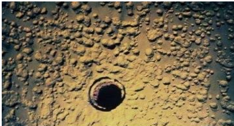
Figura 2.13 Daños por el efecto de cavitación en la succión de una bomba. (Fuente: www.nace.org )
