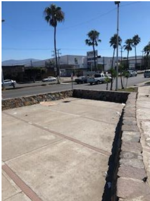
Figura 50 Estado físico de monumento Lázaro Cárdenas vista sureste. Elaboración propia (2019).
