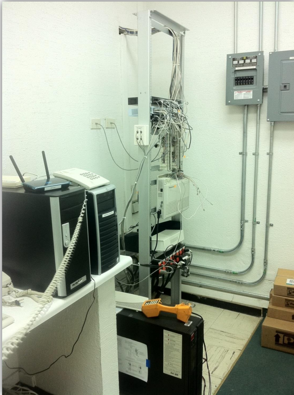
Ilustración 19: Site de Telecomunicaciones antes de la estandarización
