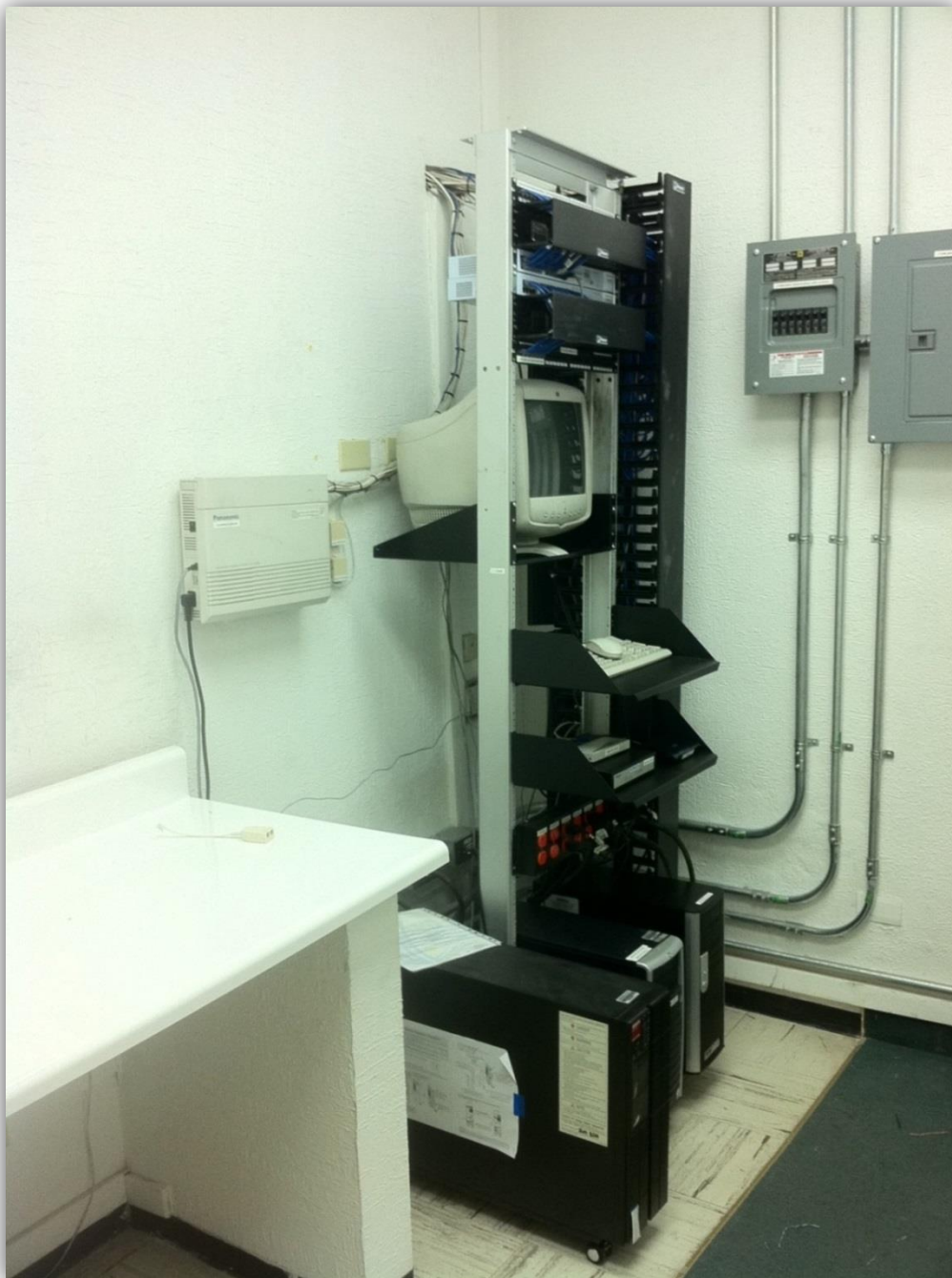
Ilustración 22: Vista lateral del Site de Telecomunicaciones ya estandarizado
