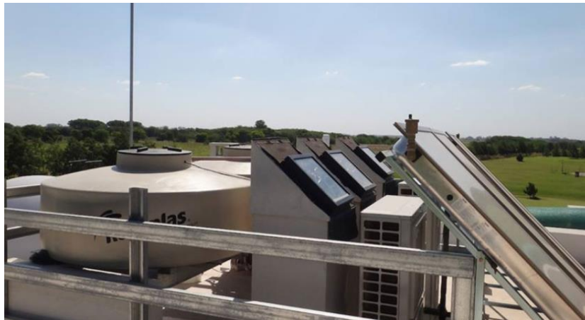
Figura 72. Captador solar en techo.
