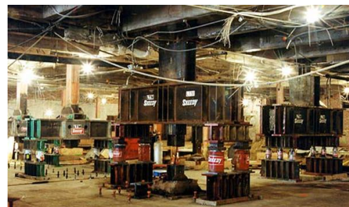
Figura 19 Aisladores de base en el San Francisco City Hall.
