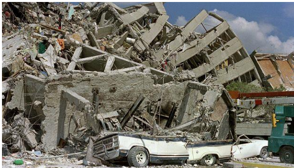
Figura 1 Daños en edificio en la Cd. de México a causa del sismo del 19 de septiembre de 1985.
