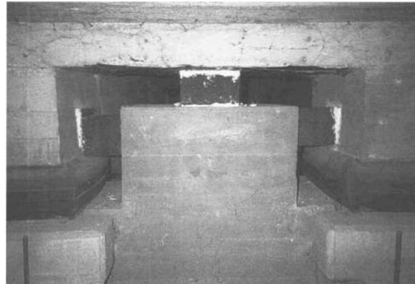
Figura 8 Aisladores de base utilizados en la Escuela Primaria Pestalozzi.
