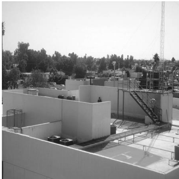
Figura 4. 9: Ubicación de equipo de aire acondicionado sobre la cubierta del Instituto de Ingeniería, UABC, Mexicali, B. C.
