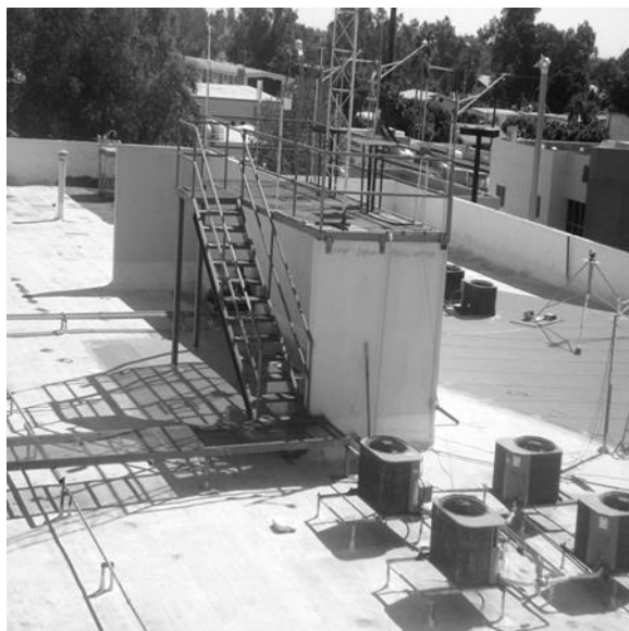
Figura 4. 10: Ubicación de equipo de aire acondicionado sobre la cubierta del Instituto de Ingeniería, UABC, Mexicali, B. C.
