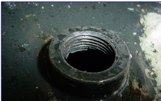
Fig. No. 14.5 – Material depositado en las cuerdas de la rosca.
