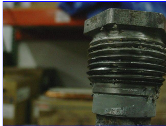
Fig. No. 14.7 – Rosca dañada en los elementos que se instalan en los coples a consecuencia de material extraño o rebaba en los coples.
