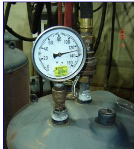
Fig. No. 15.2 Manómetro indicador de la presión instalado en el tanque de agua en la prueba de pulsaciones.
