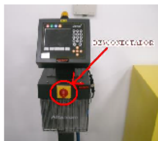
Ubicación de dispositivo de seguridad. Approval of this document is electronic
