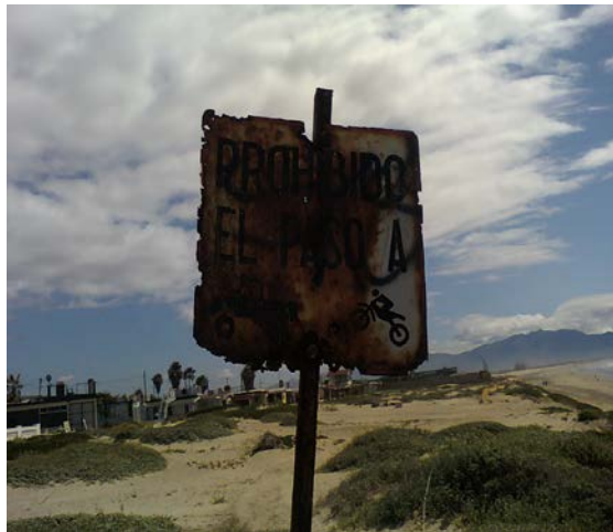
Imagen VII.- Señalamiento de Prohibido el paso, oxidado.
