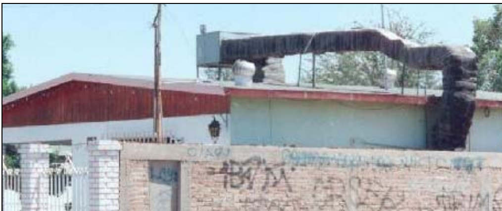
Figura 3.13 Ductos de longitud excesiva que deben evitarse
