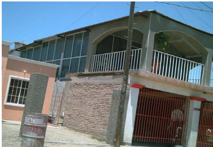
Figura 3.6 Vivienda con exceso de área de ventanas
