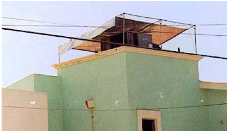
Figura 3.12 Equipo de aire acondicionado con condiciones alteradas de instalación al no permitir espacio suficiente entre el equipo y la cubierta
