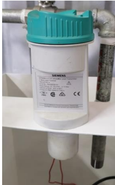
Figura 4.9 Sensor de nivel ultrasónico LU150 Siemens instalado en tanque Cuchumá.
