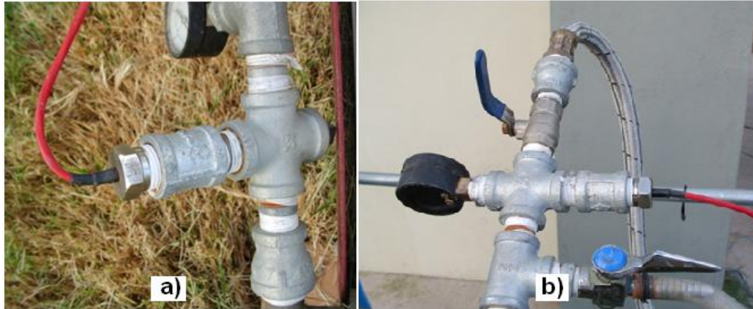
Figura 4.33 Ubicación de los sensores de temperatura a) Entrada, b) Salida del CPC.
