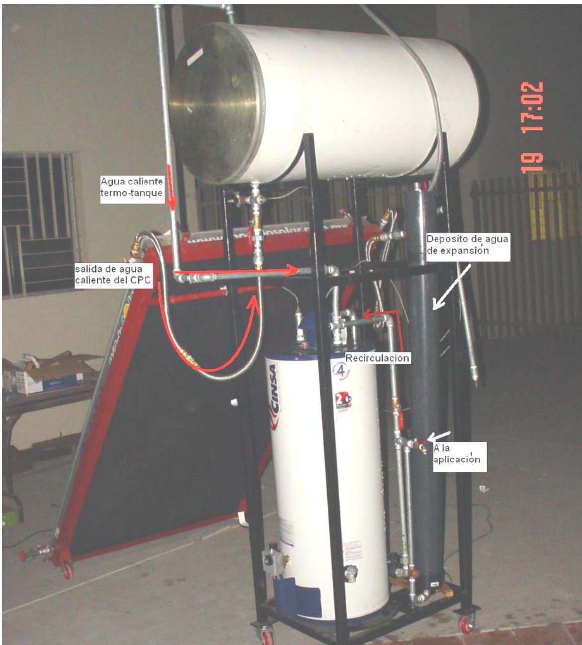
Figura 4.21 Calentador solar de agua con sistema de tuberías (vista 1).
