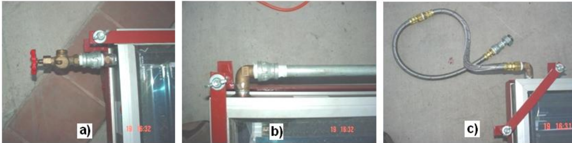
Figura 4.19 conectores de agua en el CPC a) Purga de Agua b) Entrada agua fría. c) Salida agua caliente.
