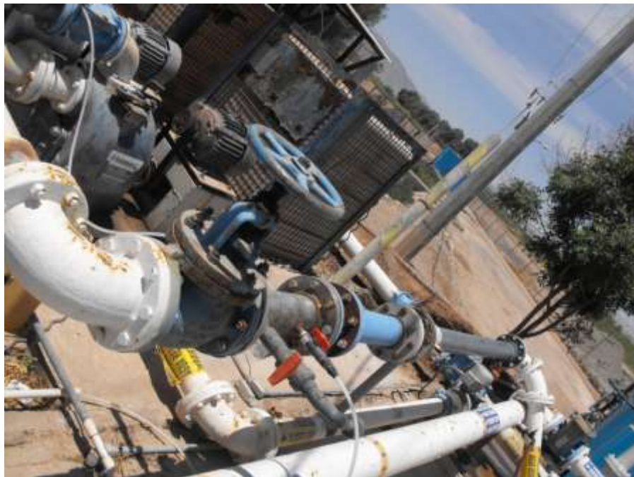
Fotografía 6.- Infraestructura de tratamiento en Planta Zaragoza, Mexicali, B.C.
