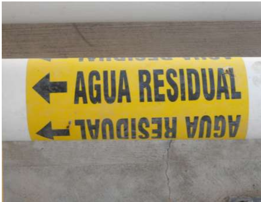
Fotografía 1.- Tubería de entrada de agua residual en Planta Zaragoza, Mexicali, B.C.
