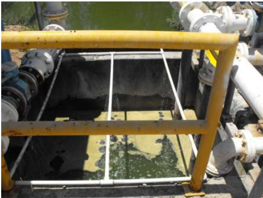
Fotografía 4.- Infraestructura de tratamiento en Planta Zaragoza, Mexicali, B.C.
