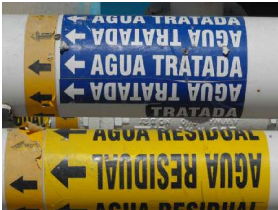
Fotografía 2.- Tubería de entrada de agua residual y salida de agua regenerada en Planta Zaragoza, Mexicali, B.C.
