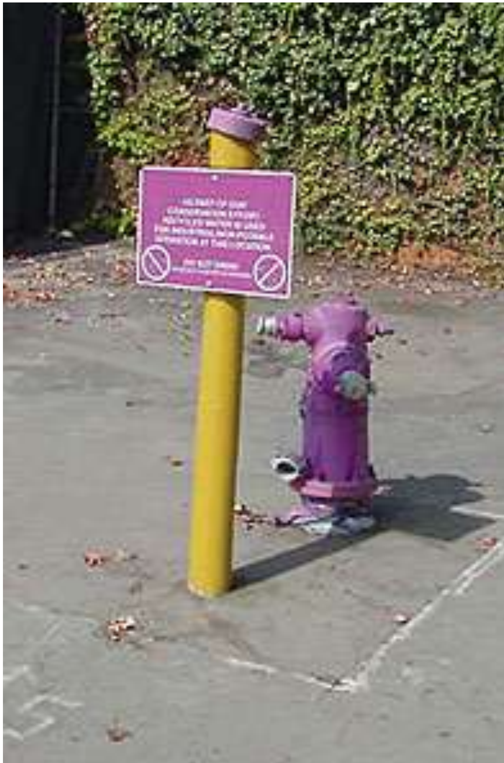
Fotografía 22.- En Inglewood, CA, se utiliza agua regenerada para uso de barredoras urbanas.
