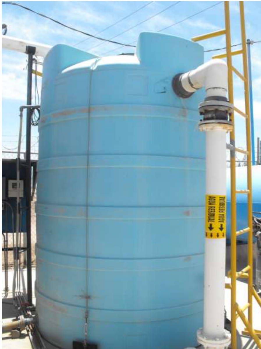
Fotografía 8.- Infraestructura de tratamiento en Planta Zaragoza, Mexicali, B.C.
