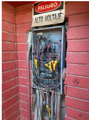
Figura 10.1. Conexión de analizador de redes a centro de carga de escuela.
