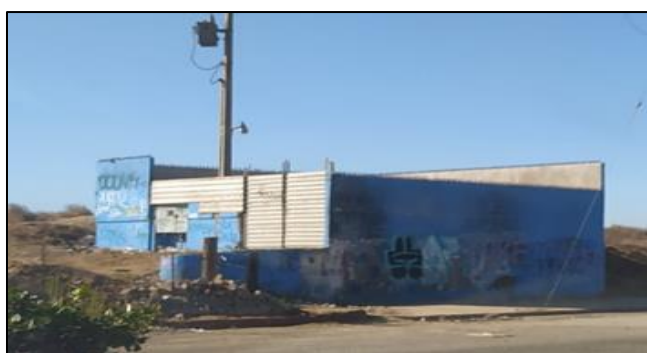
Fotografía 7. Infraestructura vandalizada 2 – Cárcamo de bombeo
