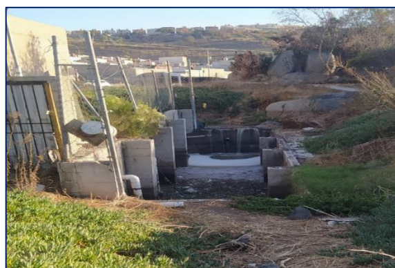
Fotografía 4. Infraestructura en mal estado – Aguas residuales 2 - Cañón de Doña Petra
