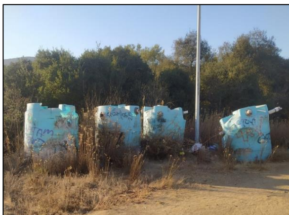
Fotografía 5. Infraestructura en mal estado – Aguas residuales 3 - Cañón de Doña Petra
