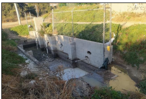
Fotografía 3. Infraestructura en mal estado – Aguas residuales 1 - Cañón de Doña Petra
