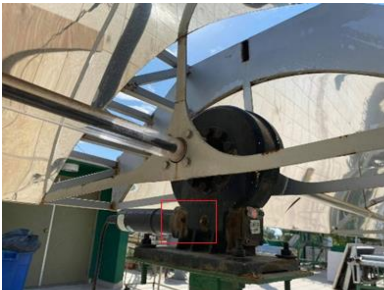
Figura 64. Motor Huafang del sistema colectores cilindro parabólicos.
