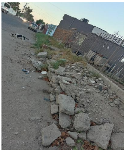
Figura 35 Banqueta fracturada en la colonia El Cóndor
