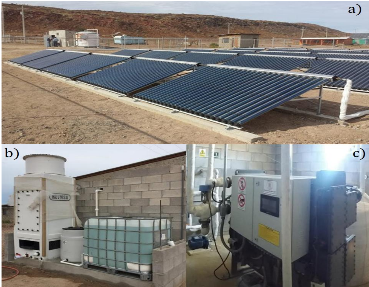
Figura 31. Sistema de enfriamiento solar en la escuela primaria de Puertecitos, BC, Mex.
