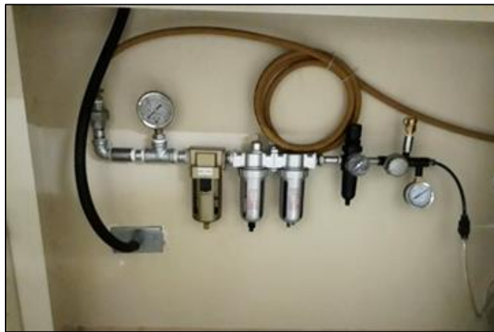
Figura 42. Sistema de filtrado de aire.
