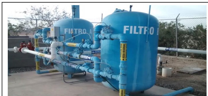
Figura 34. Filtros de la PTAR CETYS
