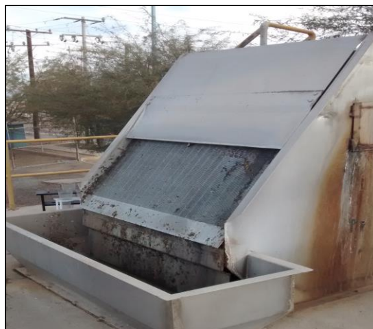
Figura 23. Vista del tamiz de la PTAR CETYS
