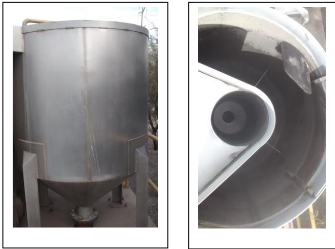
Figura 21. Vista de desarenador tipo vórtice de la PTAR CETYS
