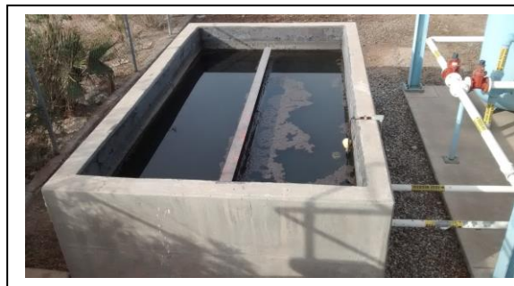
Figura 33. Cámara de contacto de cloro de la PTAR CETYS
