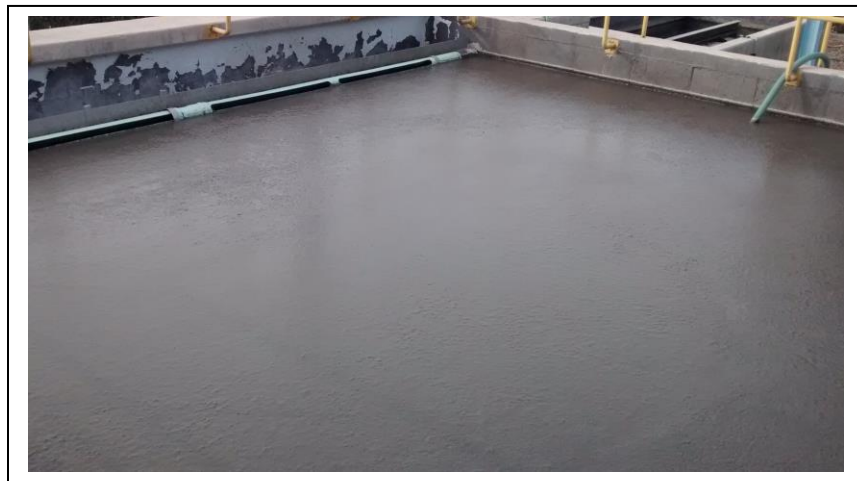
Figura 32. Sedimentador de la PTAR CETYS
