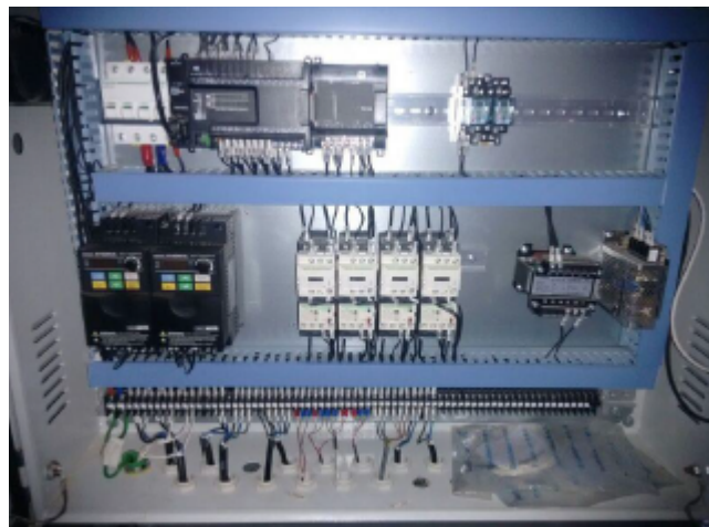
(c) Centro de control interno de la máquina LUCY
