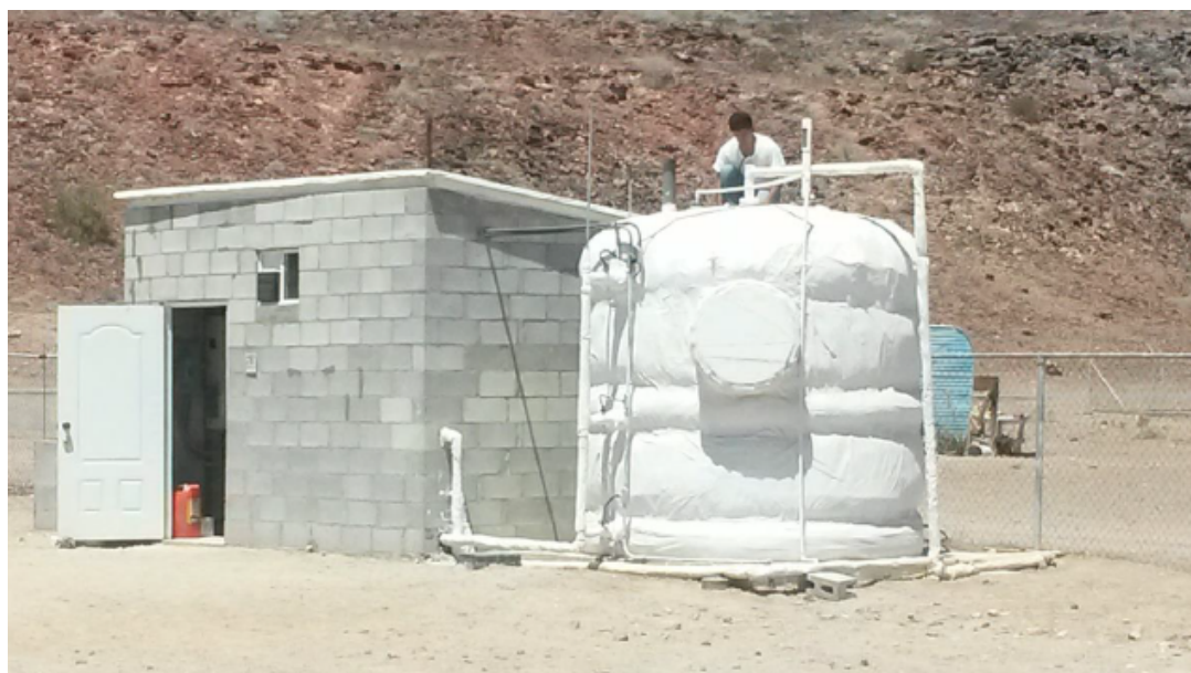
(b) Aislamiento de termotanque
