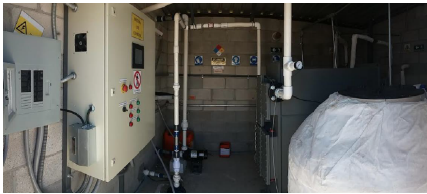
(b) PLC, relevadores y guardamoteres de control externo
