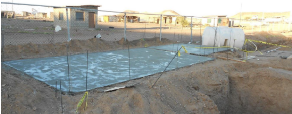
(b) Losa de concreto A.
