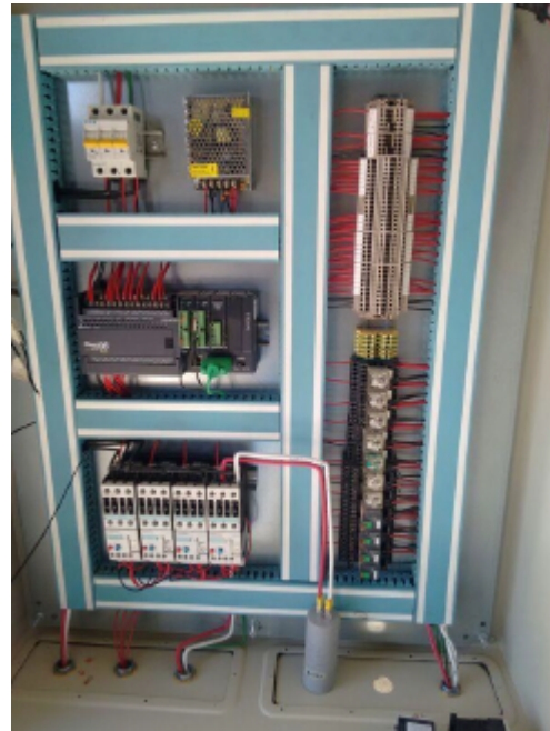
(b) PLC, relevadores y guardamoteres de control externo
