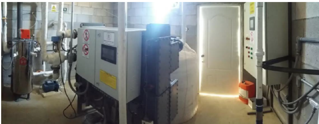
(c) Centro de control interno de la máquina LUCY
