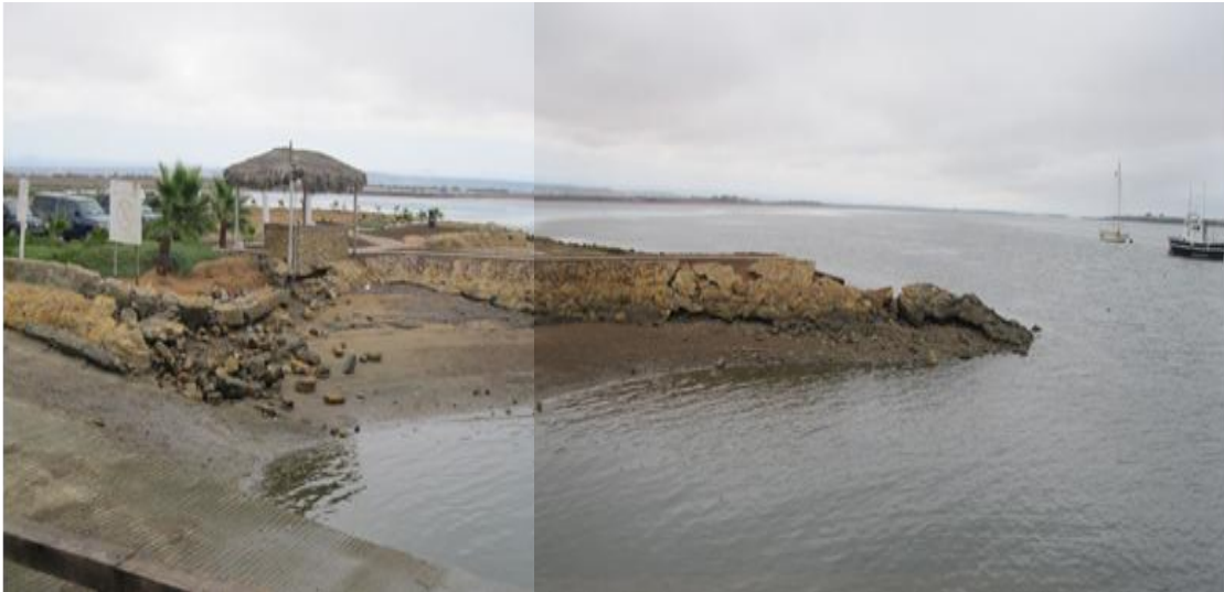
Figura 37. Lugar en Molino Viejo identificado como zona inundable (Foto de Oscar Delgado).
