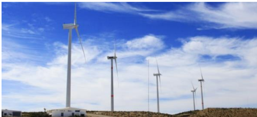
Figura 2.2. Aerogeneradores instalados en parque eólico La Rumorosa , Mexicali, Baja California.
