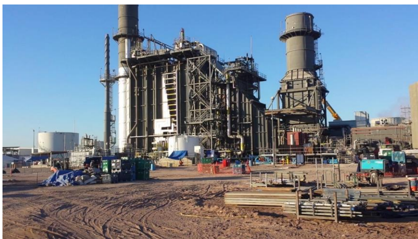
Figura 1.7. Termoeléctrica de Mexicali.
