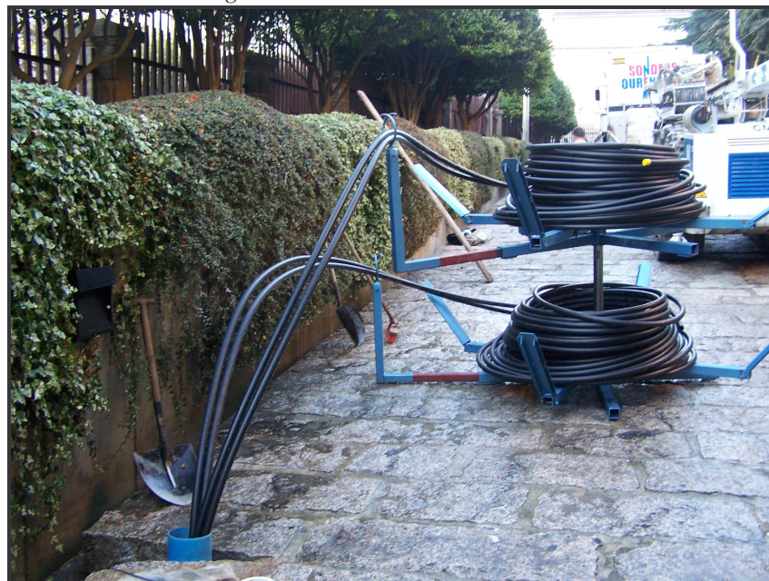
Fig 14.- Tubería PE alta densidad doble U en pozo de intercambio geotérmico.
