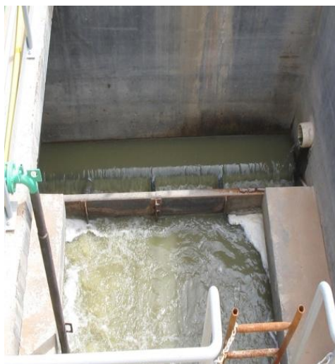
Figura 9. Desarenador de la PTAR de la ciudad de Calexico, California
