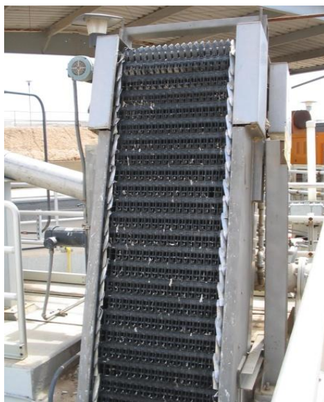
Figura 8. Sistema de cribado de la planta de tratamiento de la ciudad de Calexico, California.
