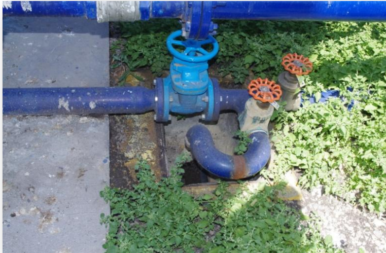
Figura 41. Válvula de purga de lodos de la PTAR-UABC.
