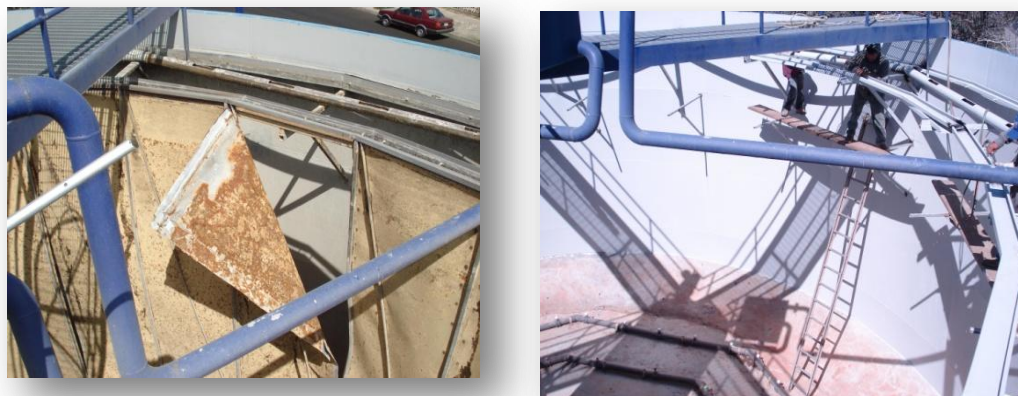
Figura 32. Antes y después de los daños ocasionados por el terremoto.
