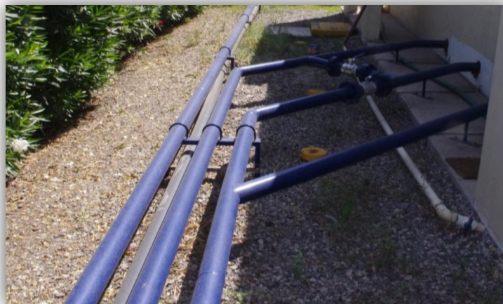
Figura 37. Configuración actual de las líneas de distribución de aire.
