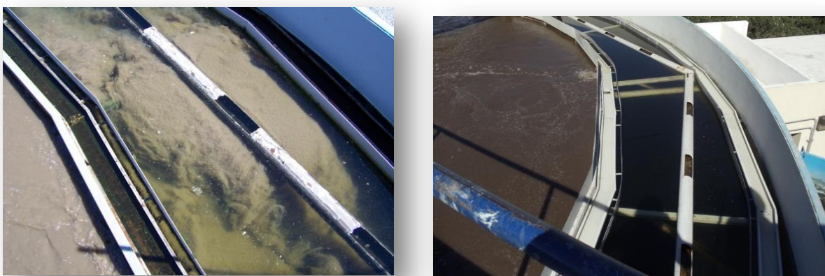
Figura 33. Cambios en la nivelación de las canaletas del sedimentador.
