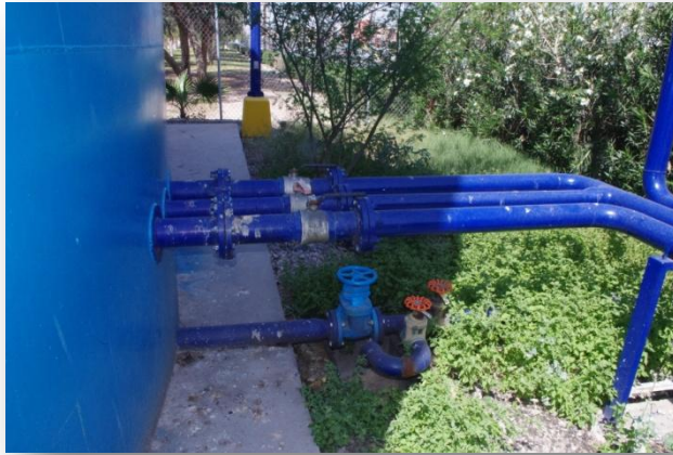
Figura 35. Recirculación de lodos de la PTAR-UABC
