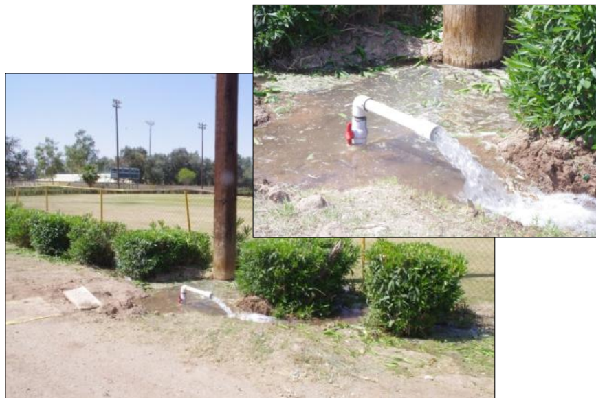
Figura 42. Llaves de riego de áreas verdes con agua blanca.
