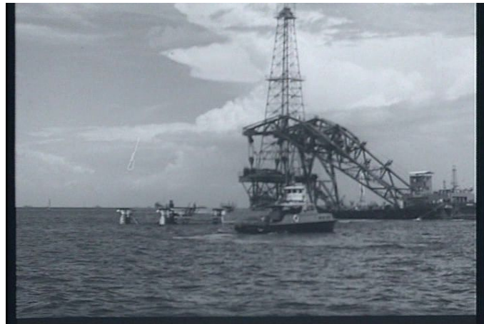
Superando los obstáculos que la naturaleza impone en el lago de Maracaibo: instalación de una torre de perforación (escena 4.21.77)
