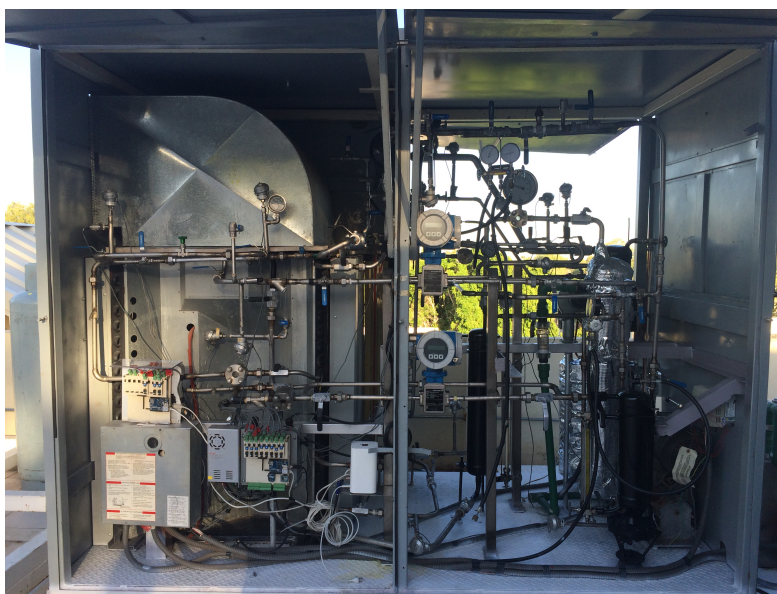
Figura 5.19: Vista final de la unidad de absorción.
