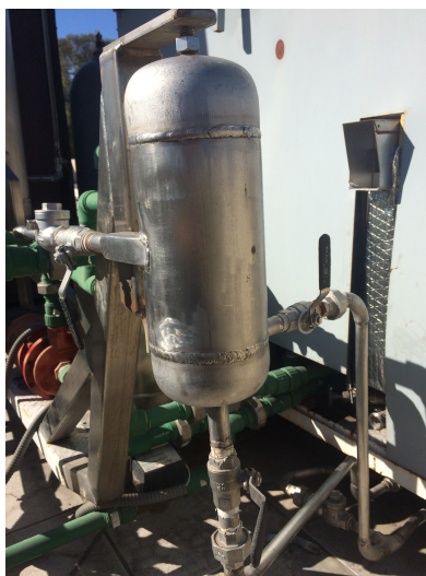
Figura 5.13: Separador de vapor de amoníaco proveniente del campo de colectores.
