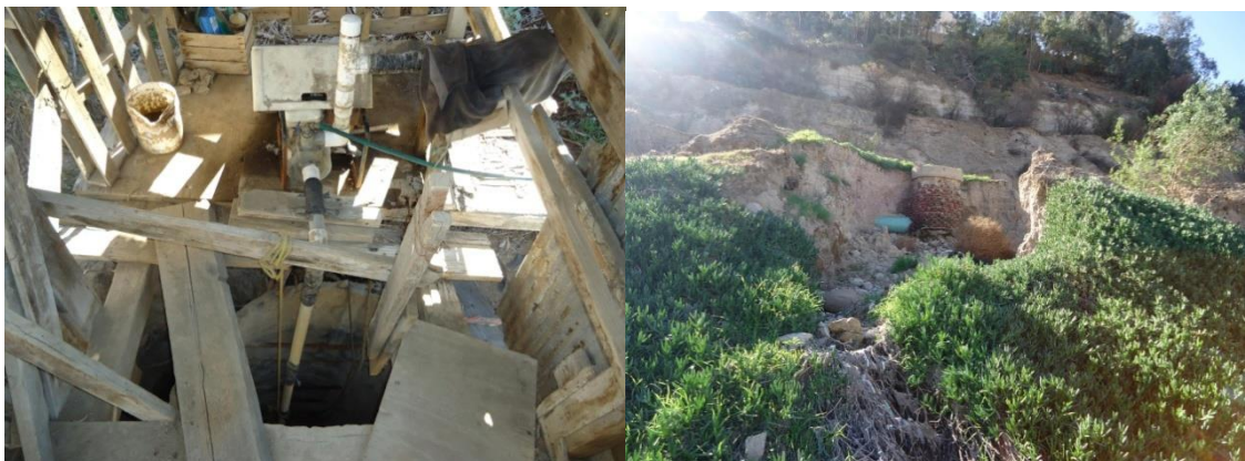
Figura 3.8 Pozo 5 y Tubería de drenaje en malas condiciones. (Fuente propia)
