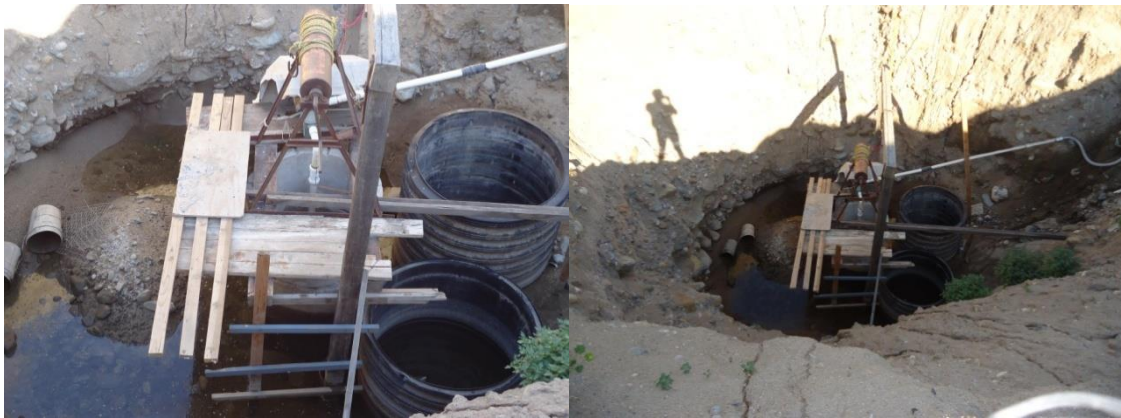
Figura 3.5 Pozo 2, utilizado principalmente para el riego de hortalizas. (Fuente propia)
