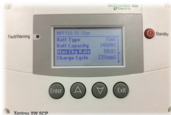
Figura 75, Configuración del banco de baterías.
