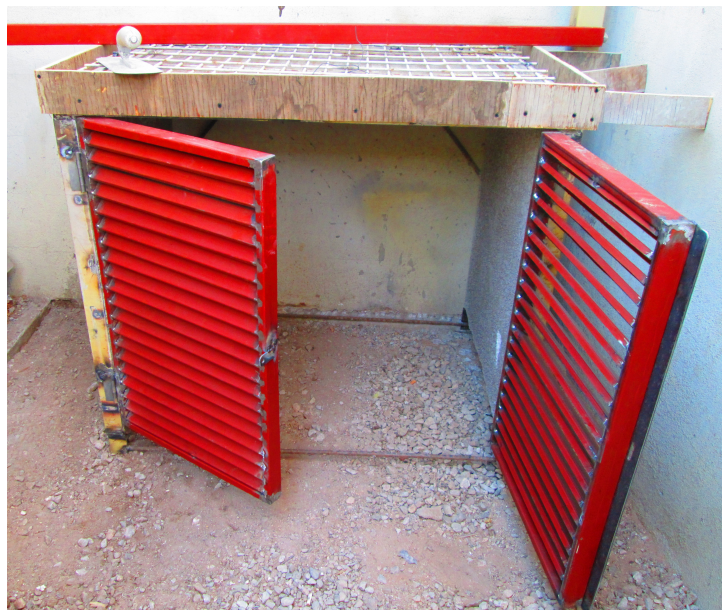
Figura 63, Base para el generador eléctrico a biogás.
