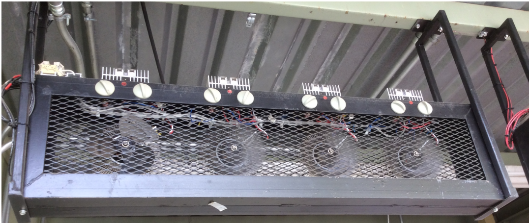
Figura 82, Cargas eléctricas activadas.
