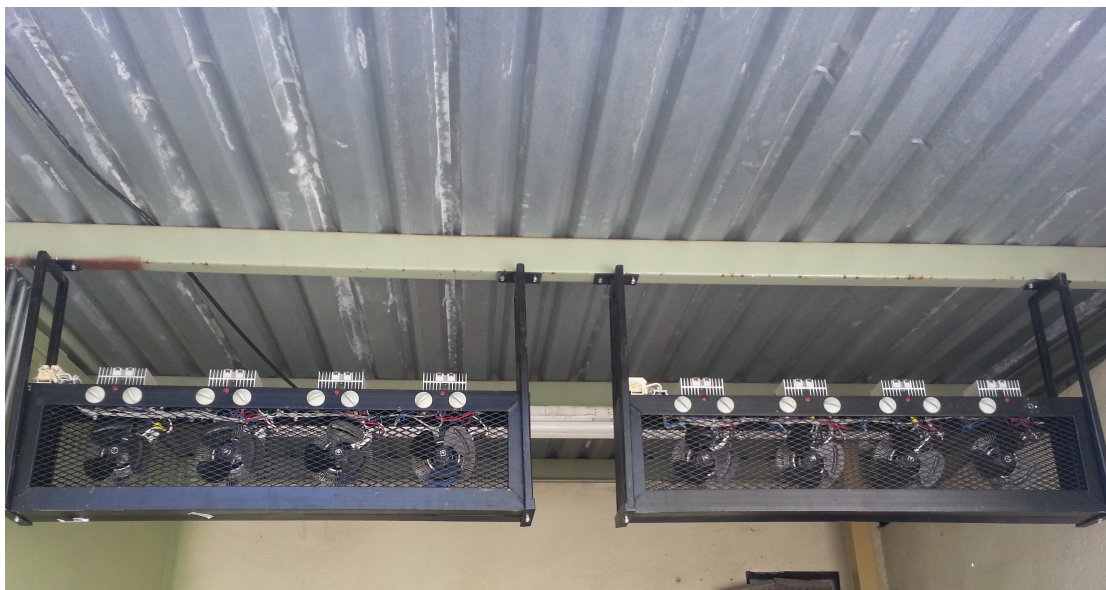
Figura 72, Instalación de cargas eléctricas variables
