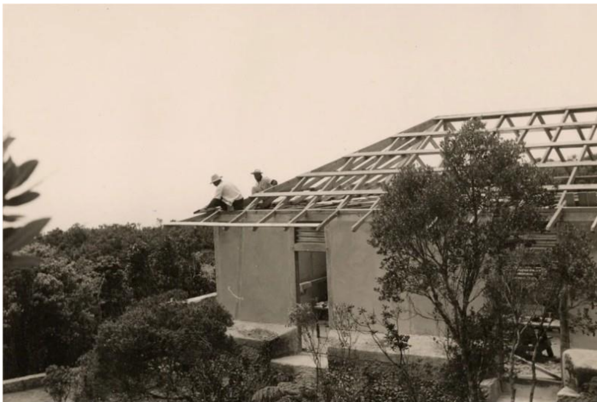
Figura No. 25 Trabajos de restauración de la hacienda La Isabelica. Fuente: Foto tomada del sitio web de la Casa Dranguet.
