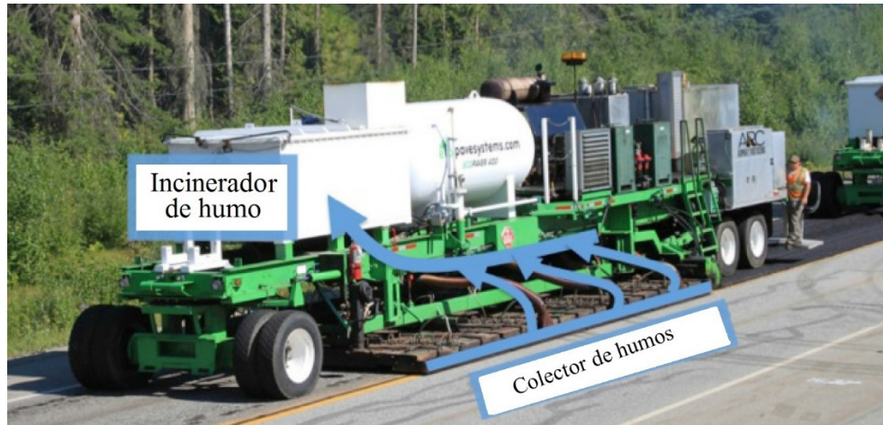
Figura 76. Incinerador de humo (Ecopave, 2018)
