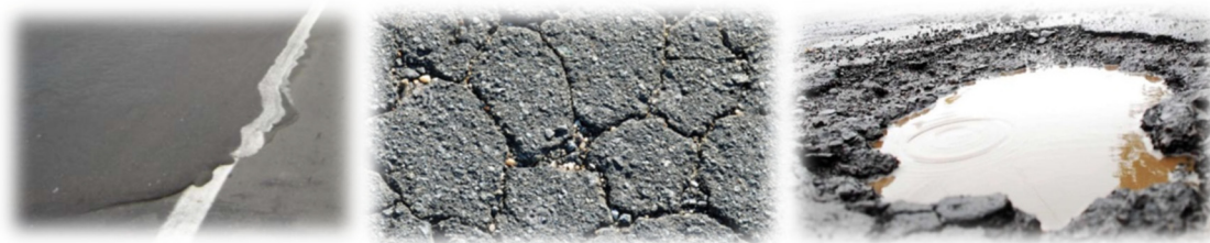
Figura 9. Daños irregularidad superficial, grietas y bache respectivamente
