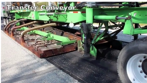
Cama calentadora y entrada de asfalto recuperado
