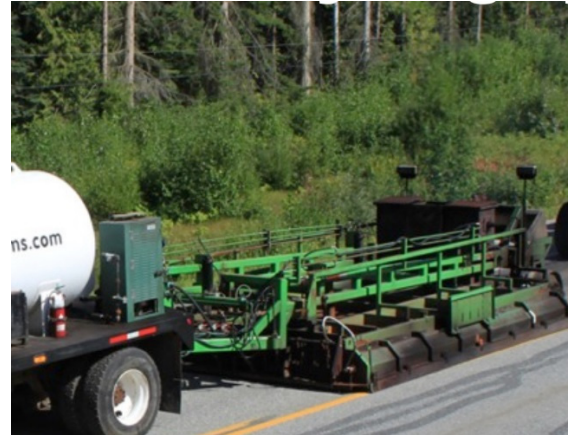
Estructura de pre calentador
