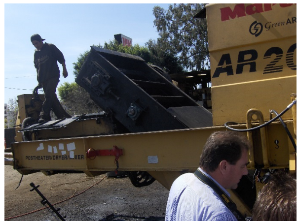
Banda transportadora que recoge la mezcla asfáltica recuperada
