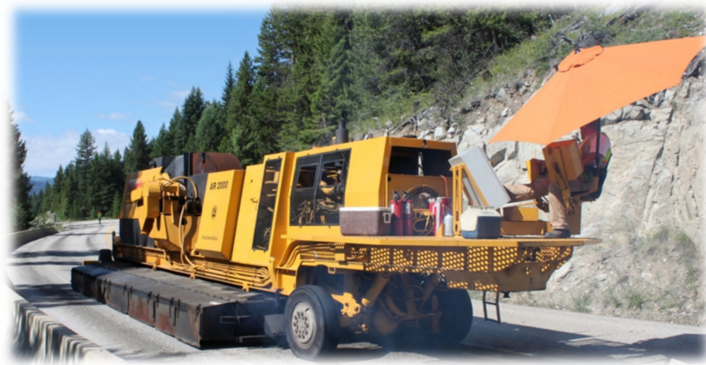
Figura 38. Pre calentador AR2000 en obra
