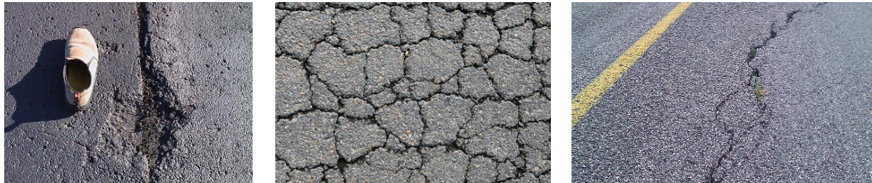
Figura 30. Baches baja profundidad, agrietamiento segmentado y grietas longitudinales
