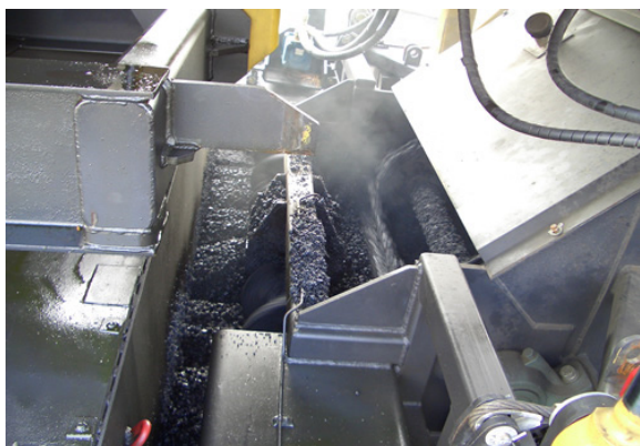
Banda transportadora hacia el mezclador de asfaltos
