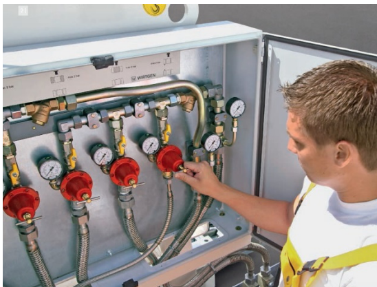
Válvulas para activar y desactivar grupos de calentadores
