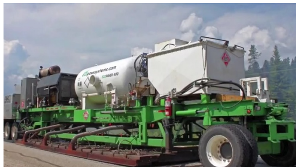
Cama calentadora y entrada de asfalto recuperado
