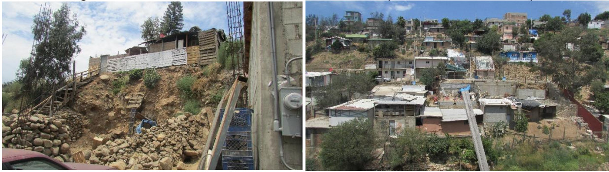
Figura 109. Situación de las modificaciones del suelo. (Colonia las Torres norte).
