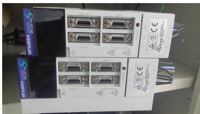
Figura 34. Drivers de potencia para los motores.
